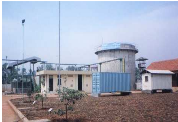
Wastewater Treatment dengan Anaerobic Digester (Fixed Bed) Rumah Potong Hewan Cakung
