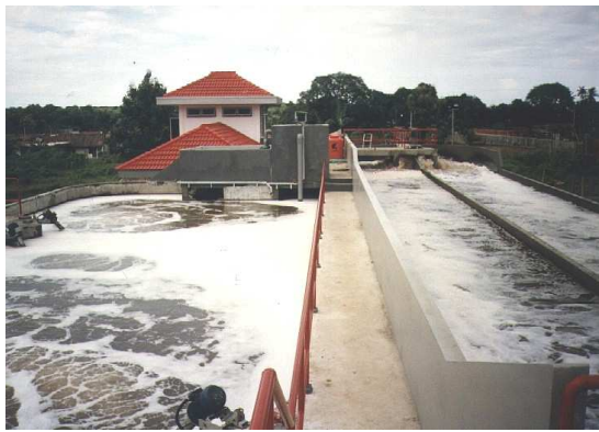
IPAL DENGAN OXIDATION DITCH
