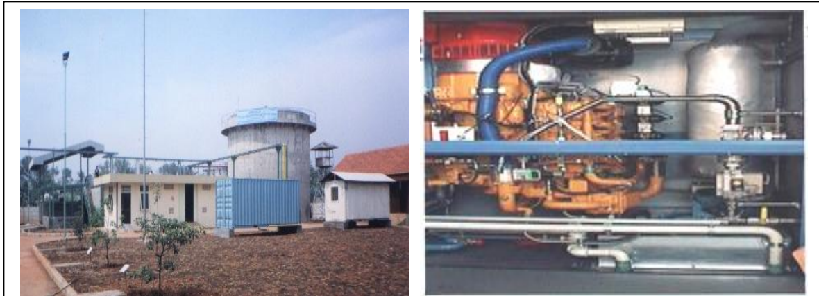
Wastewater Treatment dengan Anaerobic Digester (Fixed Bed) Rumah Potong Hewan Cakung
