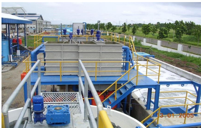
Foto : Chemco Karawang – WWTP
